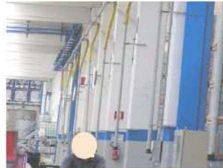
Sistema di tubazioni per la pulitura delle polveri ad "alta velocità".
