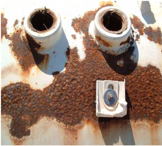
c) Serbatoio GPL
